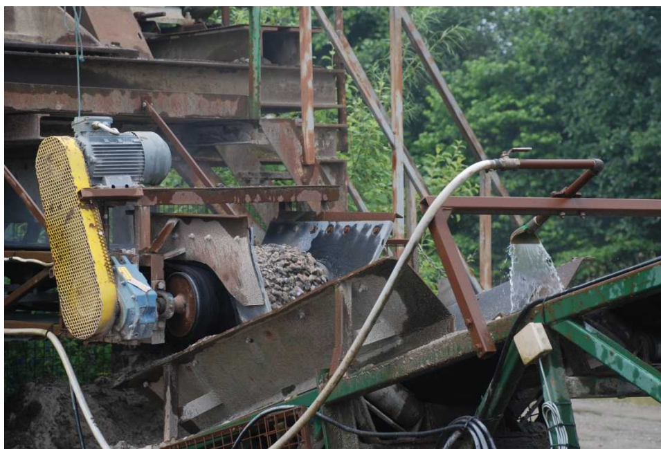
Figur 4.9: Transportbåndet der leder materialet fra kegleknuseren til materialebunken. Til højre i billedet ses en dyse, der tilfører vand til materialet for at dæmpe støvgener.
