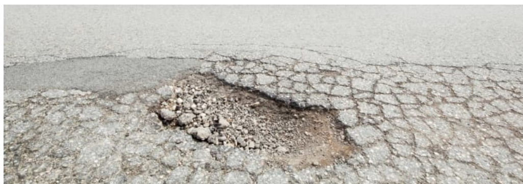
Figur 7-3: Eksempel på revner og hul i vejen, som følge af for meget trafik for tæt på asfalkanten.
