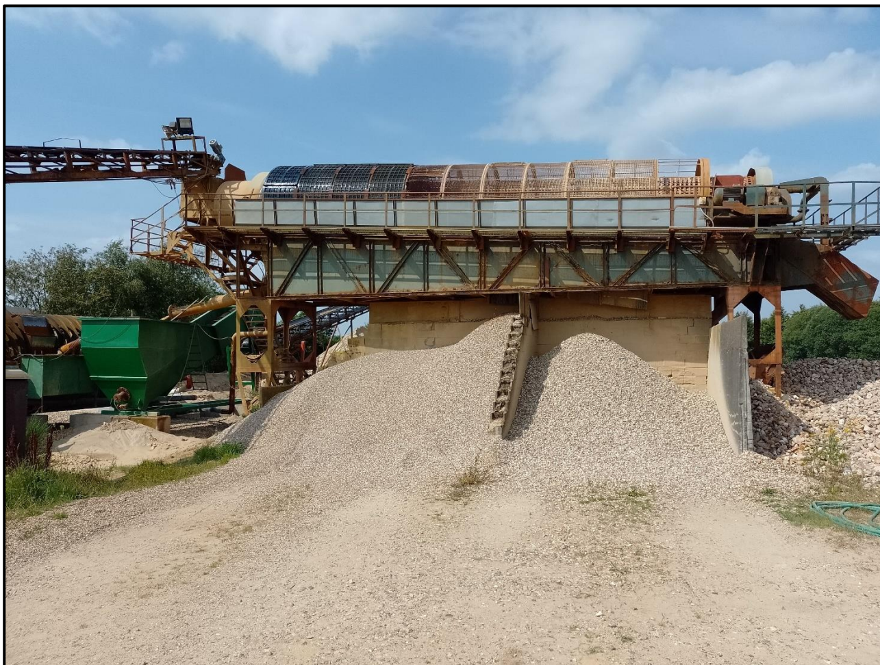
Kilde 2: Vådsorteringsanlæg, stor
