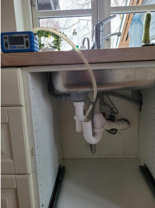
Køkkenafløb i PP-rør
